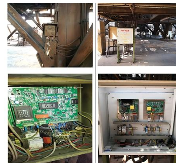
تابلو کنترل قدیم
